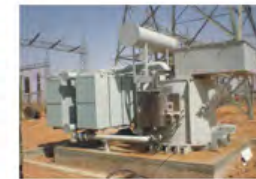
BKS-15000/11 油浸并联在苏丹国家电力公司运行 BKS-15000/11 Shunt Reactor in Sudan NEC
