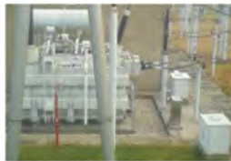
TROM-600 油色谱在线监测装置在江苏省电力公司运行 TROM-600 DGA in 500kV Substation Jiangsu Province
