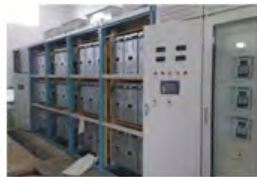
QNSVG-5000Q/10 动态无功补偿装置在上海电力公司运行 QNSVG-5000Q/10 SVG in Shanghai Power Company
